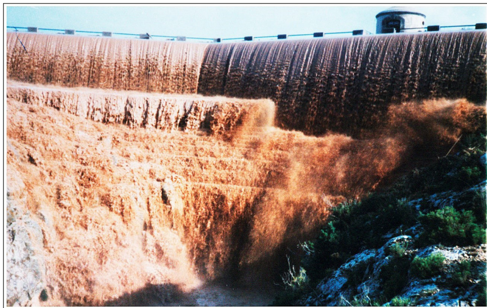
Figura 10. Desbordamiento de la presa en noviembre de 1984.
