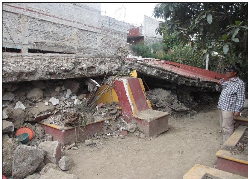
Figura 8. Vivienda de San Gregorio Atlapulco colapsada
