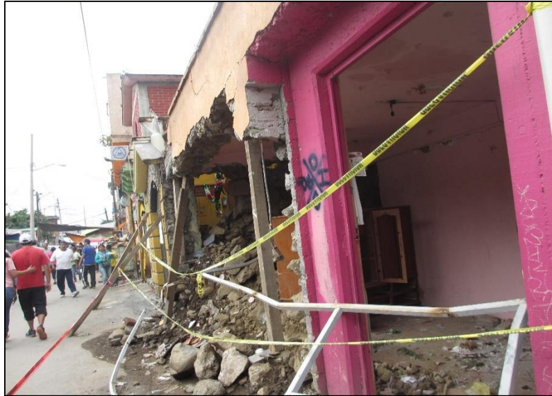
Figura 7. Vivienda de San Gregorio Atlapulco dañada
