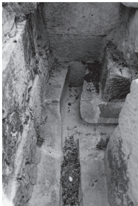
Entrada a una de las bajantes embutidas en contrafuertes con escaso mantenimiento. Catedral de Jaén.
