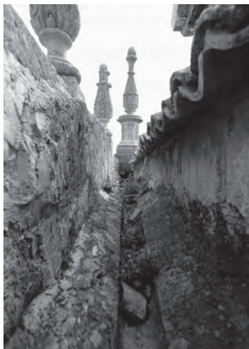
Canal con falta de mantenimiento. Catedral de Jaén.
