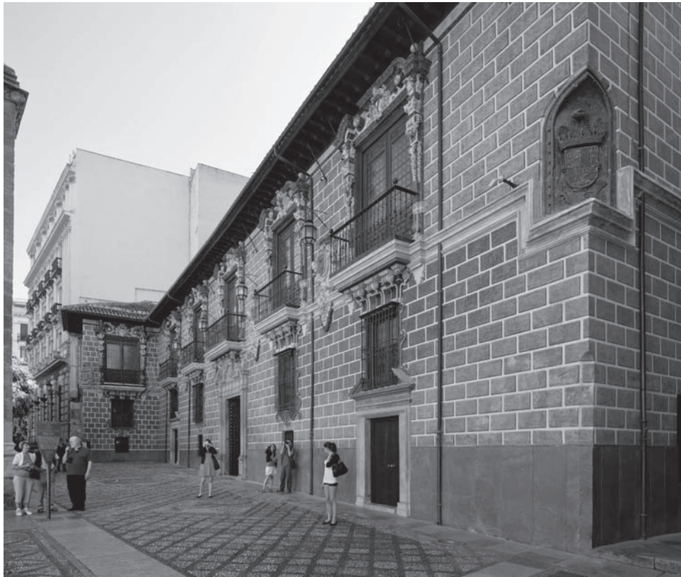
Bajantes exteriores de cobre. El sistema combinado de canales y bajantes evita la caída directa del agua en el plano inferior de fachada. Palacio de la Madraza, Granada. FOTOGRAFÍA: Fernando Alda.
