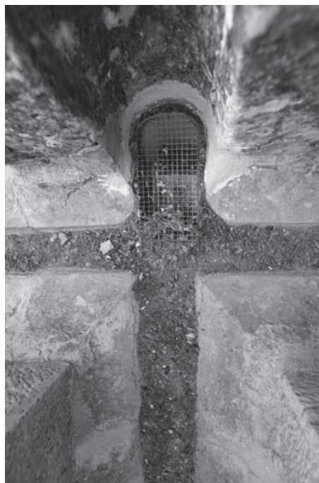
Entrada a una de las bajantes embutidas en contrafuertes protegida con rejilla después de la intervención. Catedral de Jaén.
