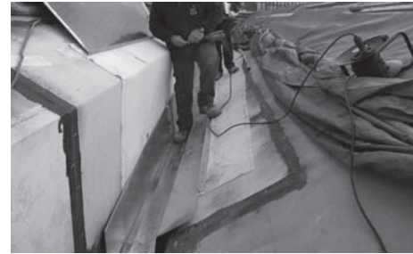
Tela asfáltica de alta durabilidad protegida con chapa de cobre de 1 mm en una canal de las cubiertas laterales de la Catedral de Jaén.
