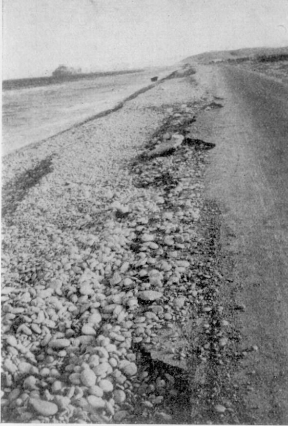
Fig. 1. — Carretera de Benicarló-Peñíscola. La acción del oleaje ha superado las defensas artificiales (gaviones) y está atacando ya el pavimento de la carretera asfaltada muy recientemente. (Foto obtenida en mayo de 1963).
